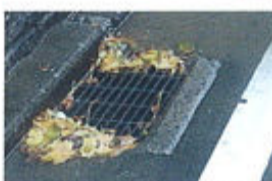
落葉による集水の障害
